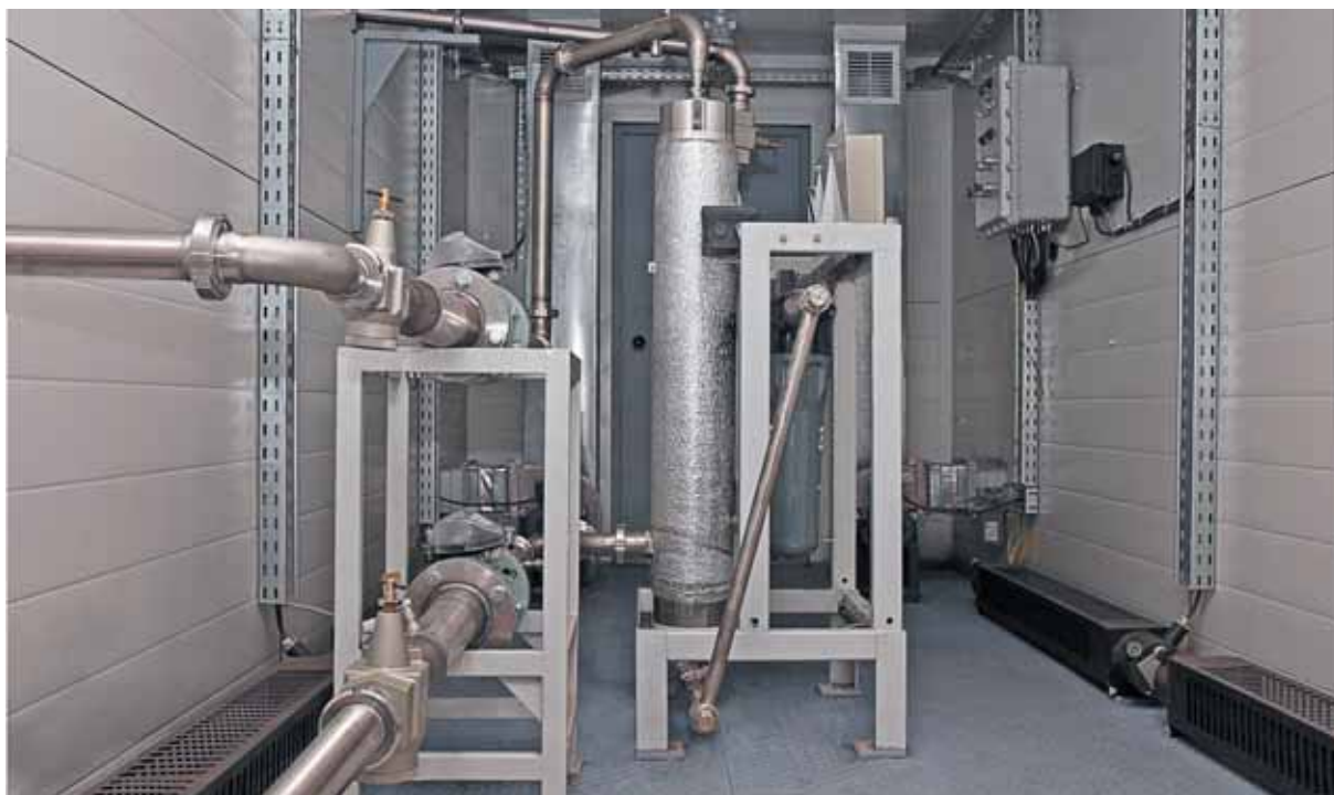
Мембранная установка подготовки попутного нефтяного газа.
