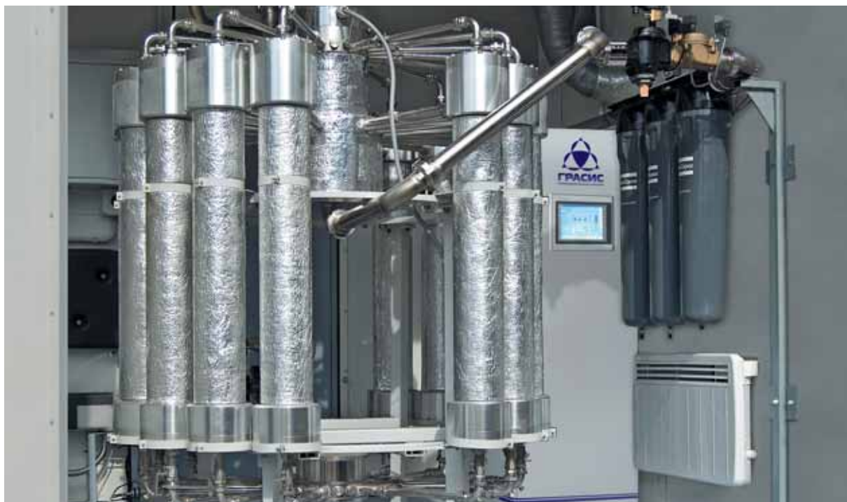
Заказчик — ОАО «Газпром». Производительность — 1000 нм 3 /ч, чистота азота — 95%.
